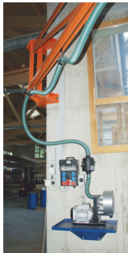
Die kompakte Vakuumpumpe mit Staubfilter ist direkt beim Schaltkasten montiert. Darüber gut sichtbar ist die robuste Wandkonsole des GIS-Drehkrans.
